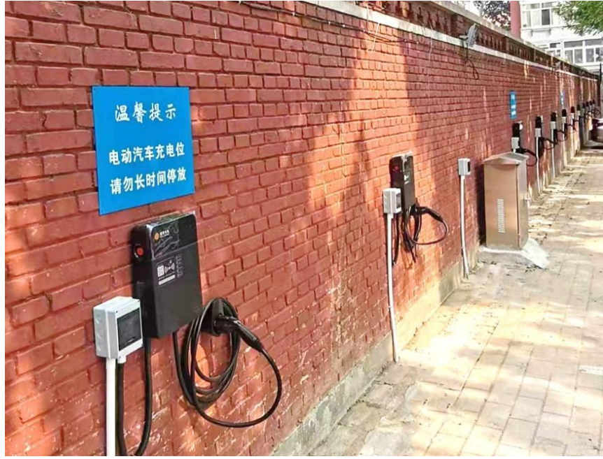
图注 38：增设电动汽车充电桩
